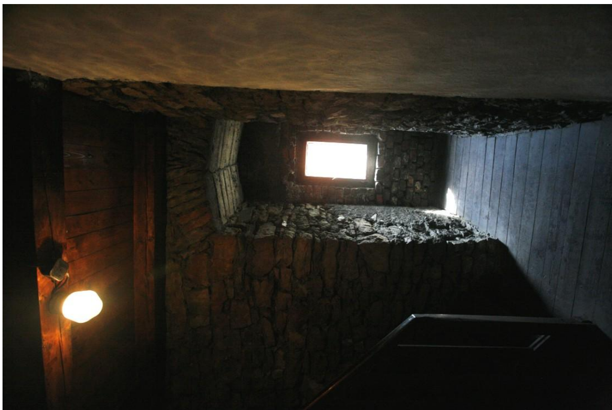
Fot. 11. Bystrzyca Kłodzka, Wieża Bramy Kłodzkiej, poziom + 8,15 – zablokowany otwór wejścia na ganek.
