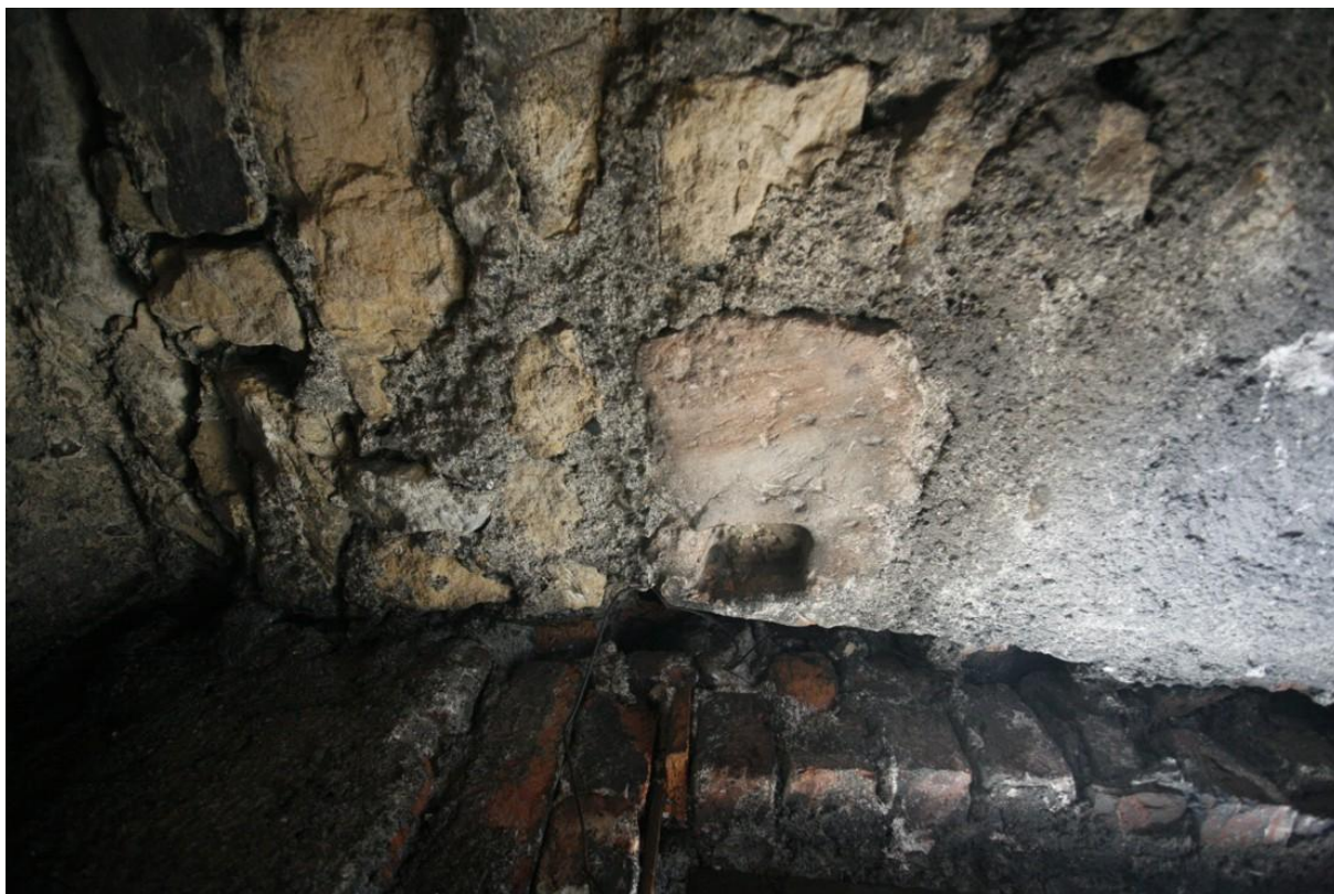
Fot. 12. Bystrzyca Kłodzka, Wieża Bramy Kłodzkiej, poziom +8,15 – zablokowany otwór wejścia na ganek, ościeże południowe.
