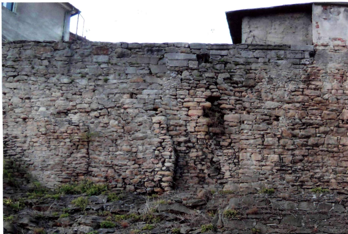
FOT. 19. SPĘKANY FRAGMENT MURU, ODCINEK F-G.
