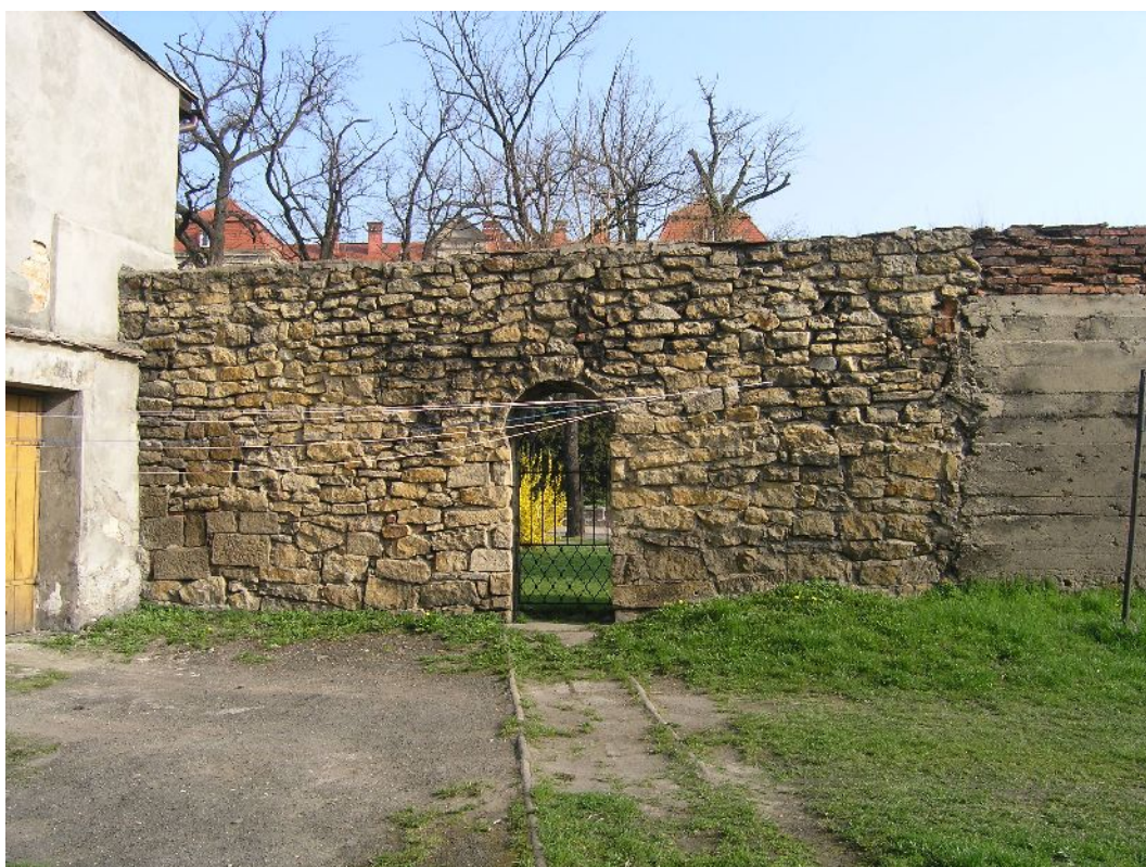
Fot. 16. /F-G/ Strona południowa. Ubytki spoin na znacznej powierzchni muru. Luźne kamienie. Krzewy na koronie.
