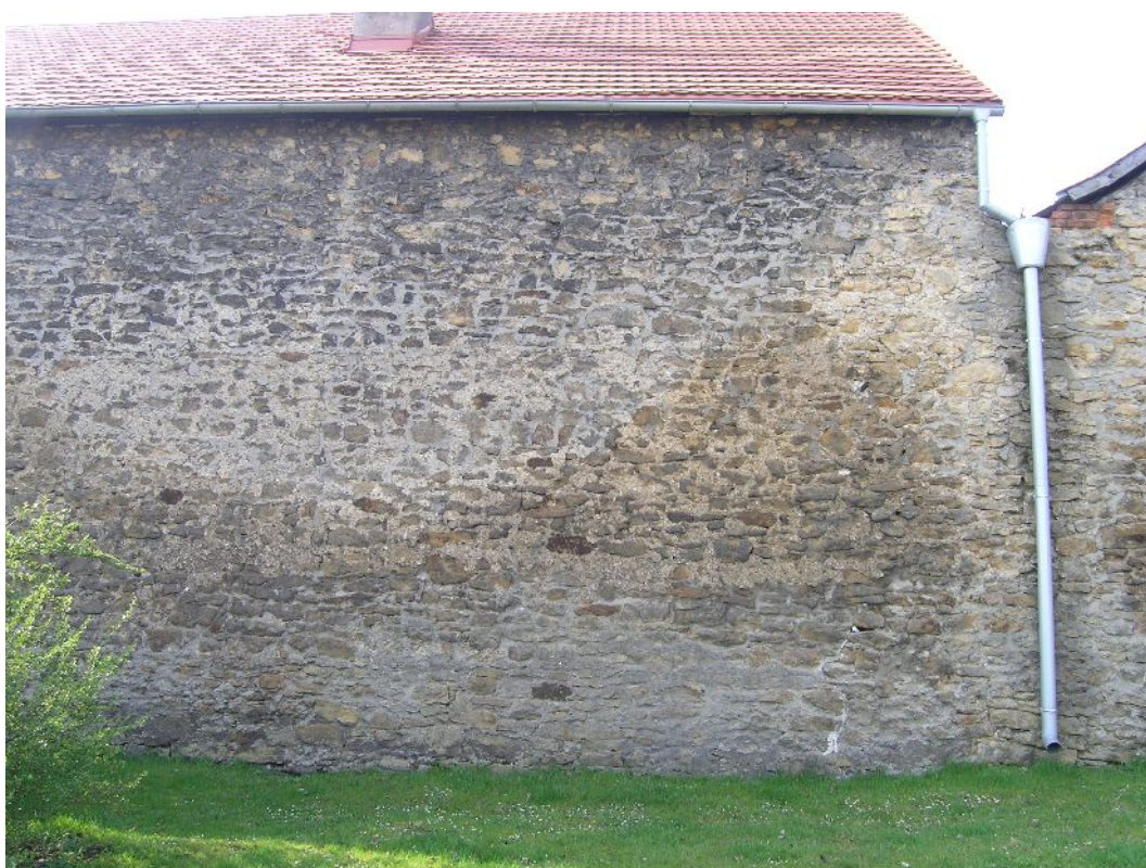
Fot. 2. /C-D/ Zniszczona, zawilgocona powierzchnia muru. Zniszczenia cokołu. Pozostałości tynków.
