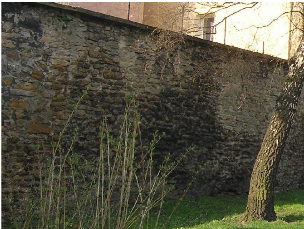
Fot. 1. /B-C/ Zniszczone lico kamienne, pozostałości tynków. Betonowe nakrywy z pozostałościami ogrodzenia / słupków.
