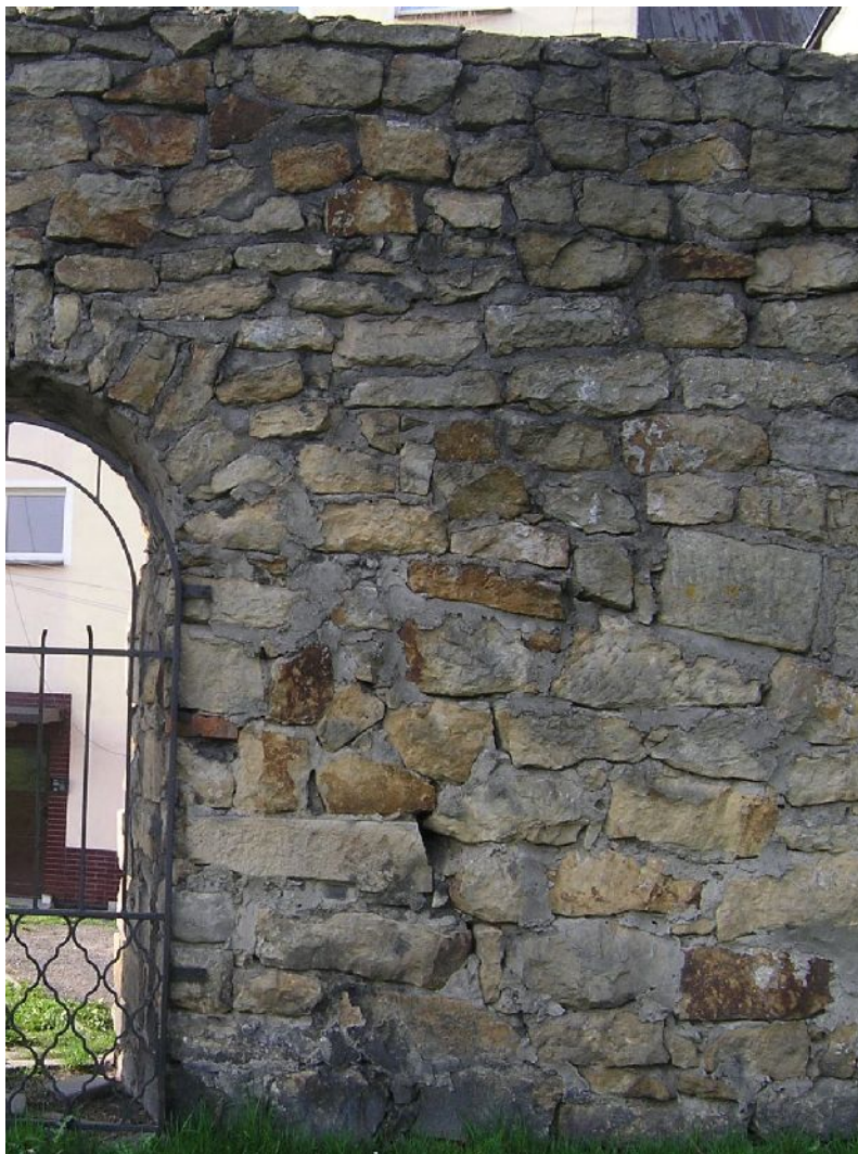
Fot. 11. /F-G/ Spękania uzupełnione zaprawą cementową – wtórne pęknięcia.
