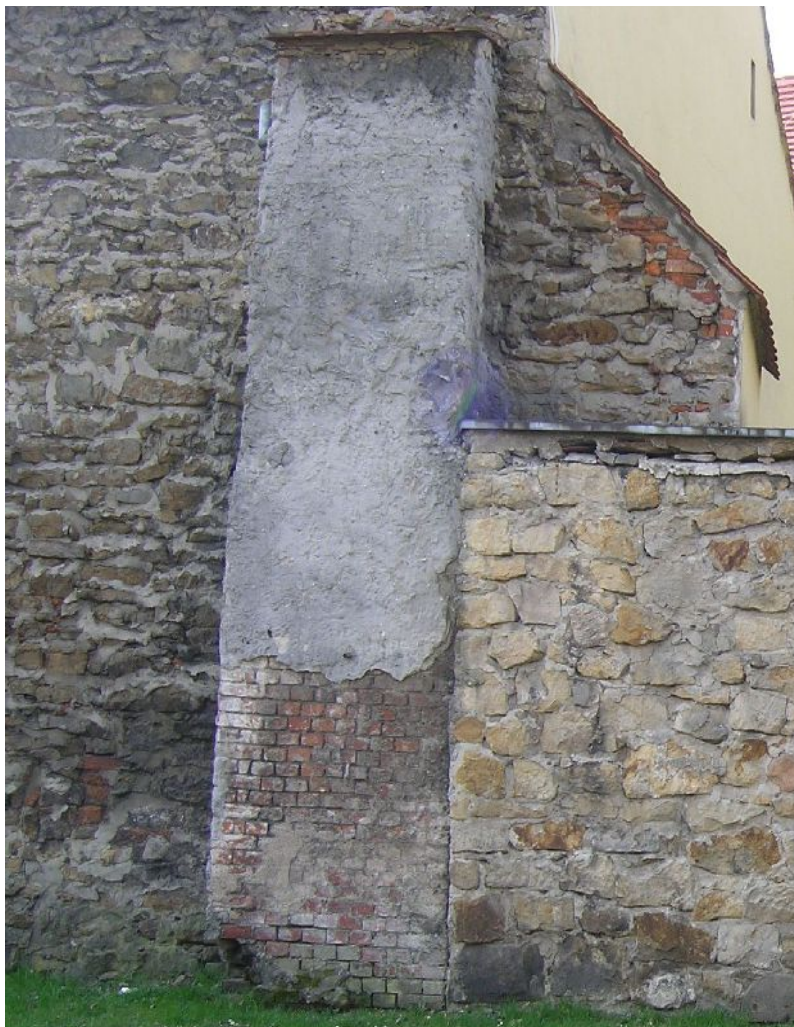
Fot. 24. /L/ Kolejne etapy rozbudowy. Wszystkie mury znacznie zniszczone, wilgotne i zagrzybione. Odspojona korona współczesnego muru.
