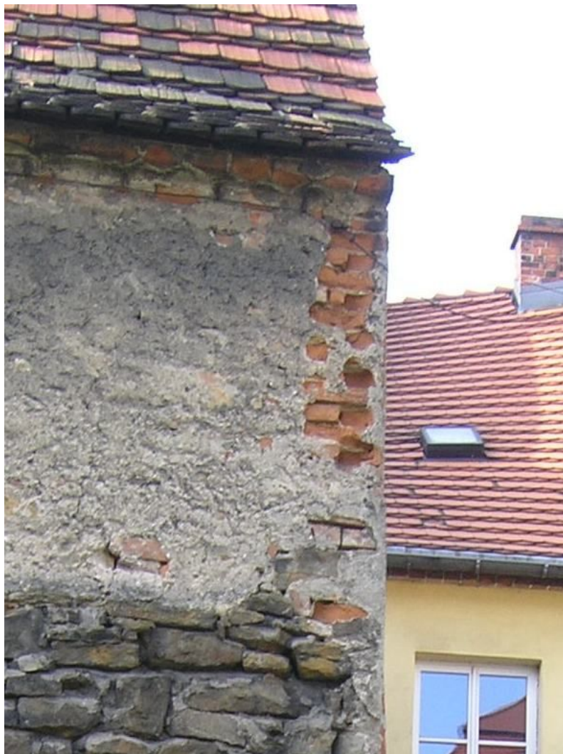
Fot. 18. /I/ Zniszczony narożnik budynku. Ubytki w cegle.
