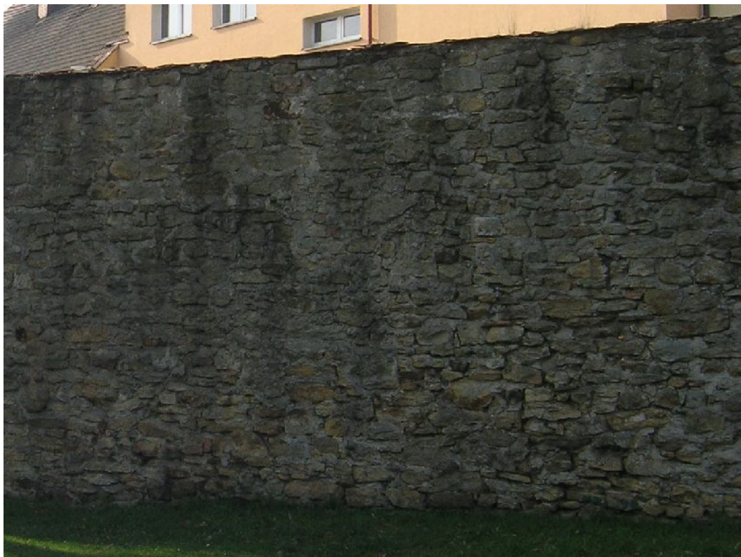
Fot. 9 /E-F/ Ubytki spoin i kamieni. Brak zabezpieczenia korony.
