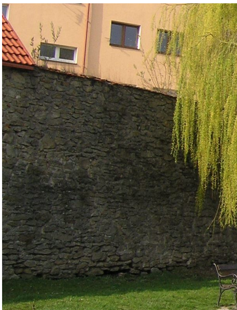
Fot. 6. /E-F/ Zniszczone lico kamienne. Ubytki kamieni w pasie cokołowym. Korona muru porośnięta krzewami i trawą.
