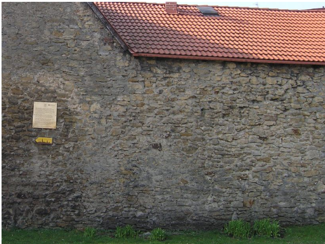
Fot. 5. Zdegradowana struktura lica, przemurowanie w rejonie okapu. Zniszczenia w pasie cokołowym.
