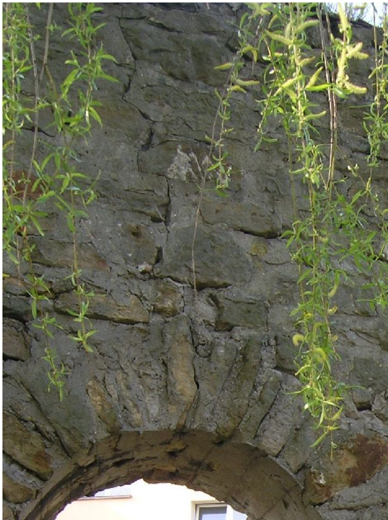
Fot. 8. /E-F/ Pęknięcie muru w strzałce łuku.
