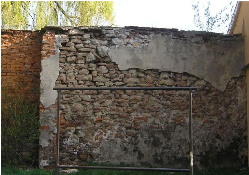
Fot. 13. /E1-E2/ Zdegradowane lico muru. Resztki tynków cementowo-wapiennych – zagrzybione, zawilgocone. Luźne kamienie głównie w pasie górnym. Brak zabezpieczenia korony. Krzewy na murze.
