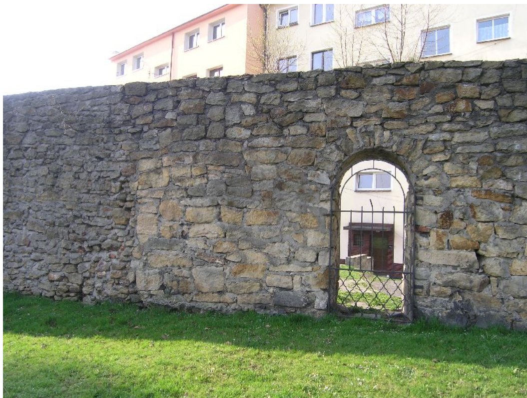
Fot. 12. /F-G/ Wyplukane spoiny wielokrotnie uzupełniane. Rozluźnione kamienie. Roślinność na koronie i licu muru.
