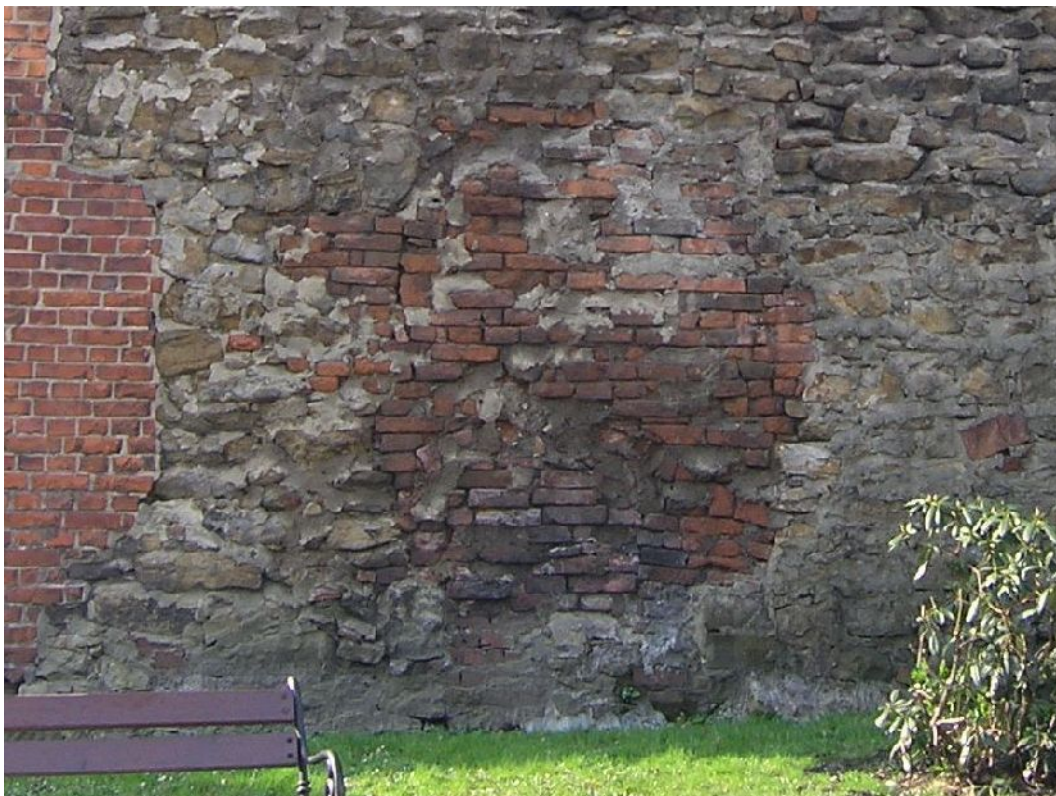
Fot. 21. /K/ Najbardziej zniszczone miejsce muru. Wielokrotnie uzupełniane, wyrzuczone.
