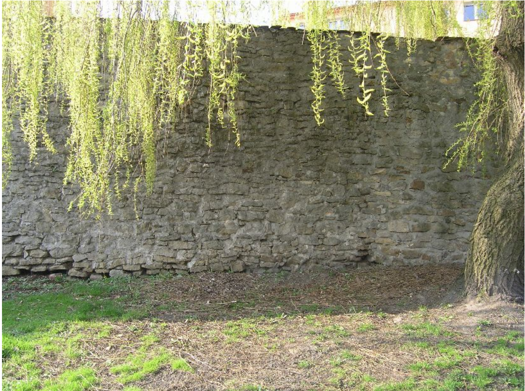
Fot. 7. /E-F/ Znaczne ubytki kamieni w przyziemiu. Brak zabezpieczenia korony.
