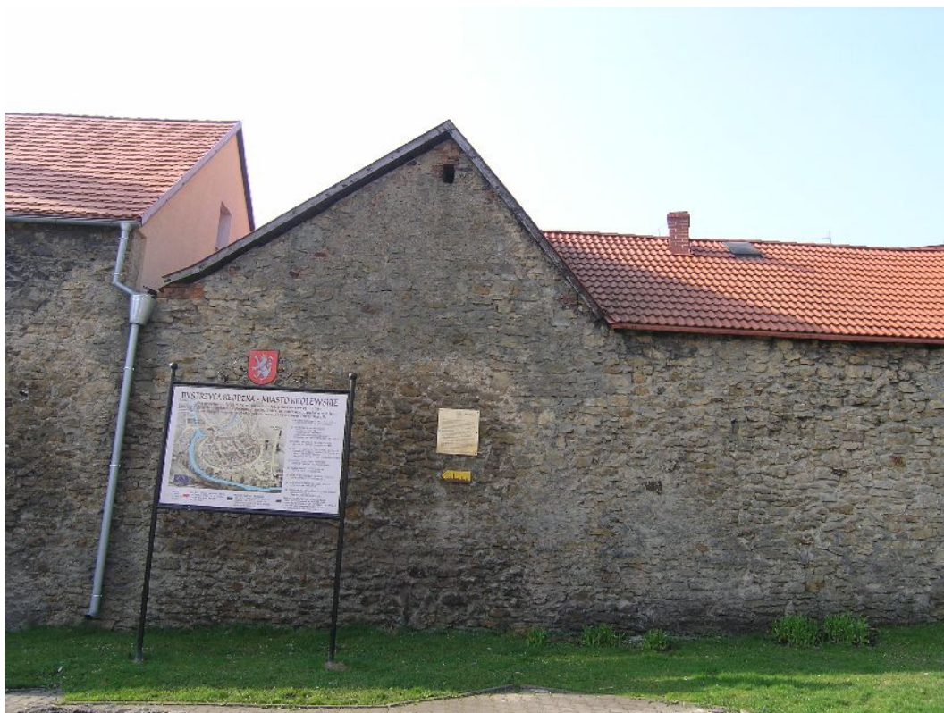
Fot. 4 /D-E/ Zniszczona struktura muru, brakujące spoiny. Duże zawilgocenie. Pozostałości wypraw. Ubytki w pasie cokołowym
