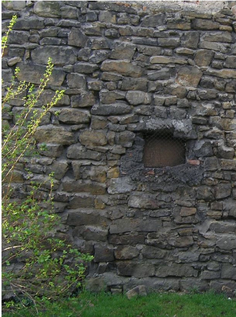
Fot. 19. /H-I/ Popękany narożnik budynku. Rozluźnione kamienie, brakujące spoiny.
