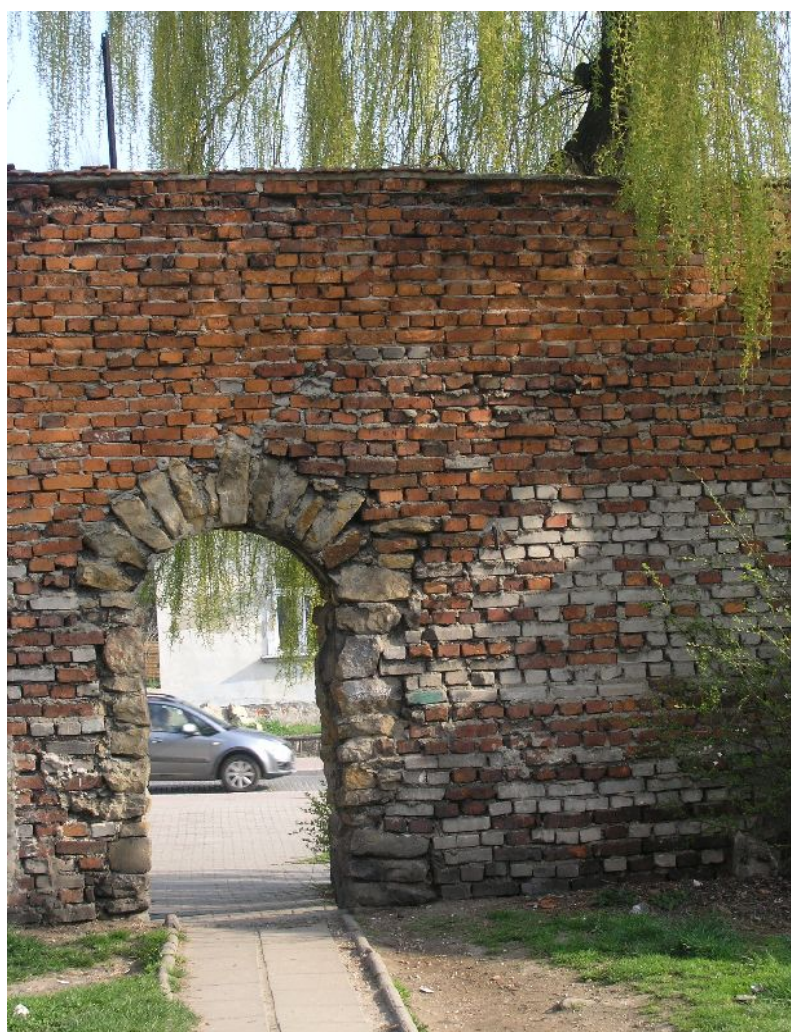
Fot. 14. /E-F/ Przewidywany materiał w południowym licy muru – bardzo zniszczony, niestabilny zwłaszcza w pasie górnym.
