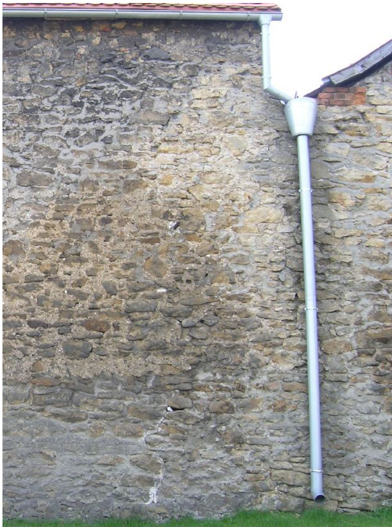
Fot. 3. /D/ Ślad pęknięcia wzdłuż krawędzi ściany.
