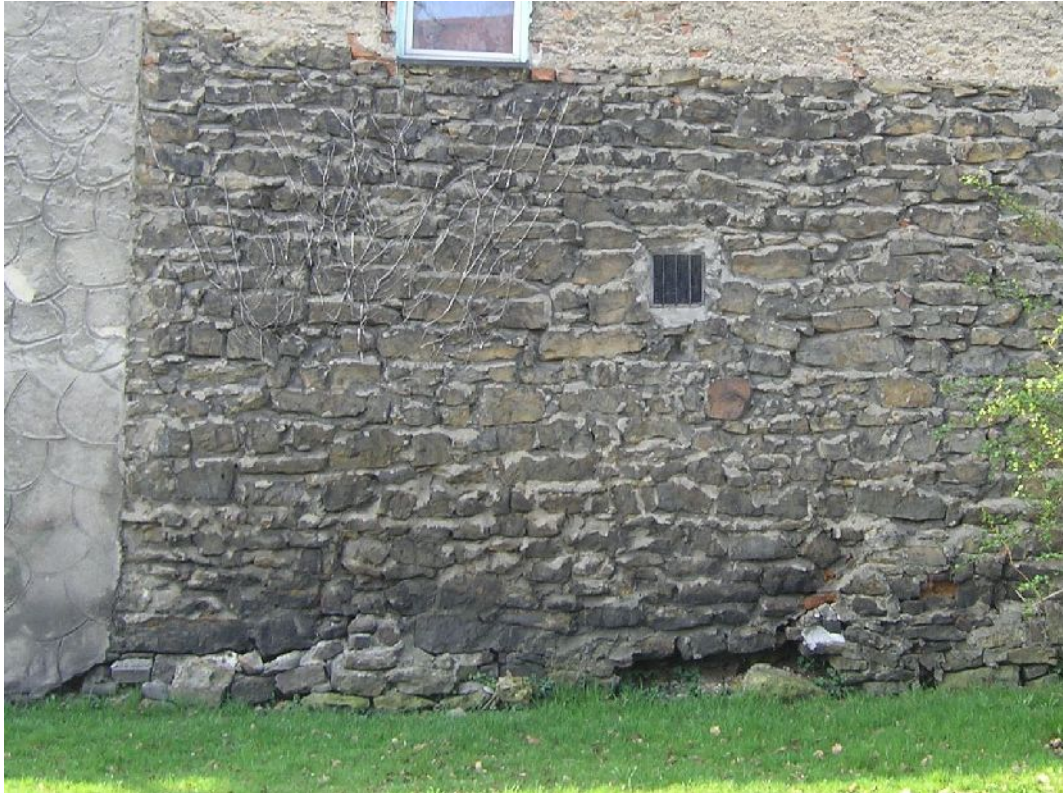
Fot. 17. /H-I/ Znaczne zniszczenie w pasie przyziemia z doraźnymi przemurowaniami.
