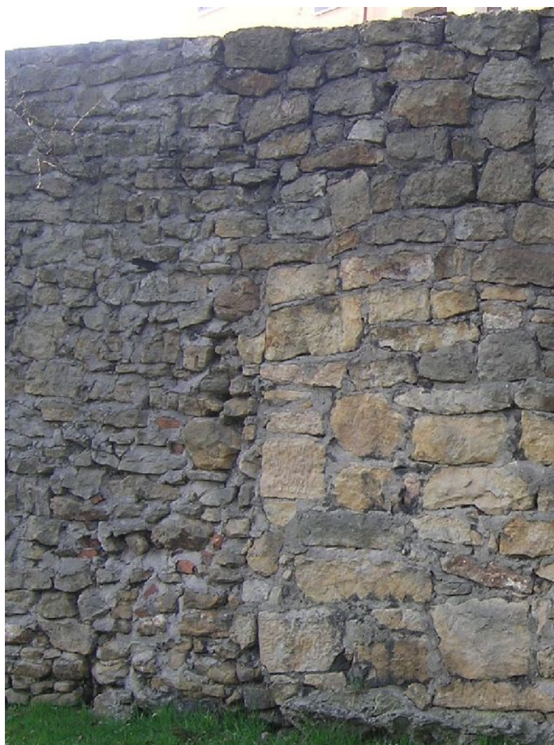
Fot. 10. /F/ Zniszczenie na łączeniu murów.
