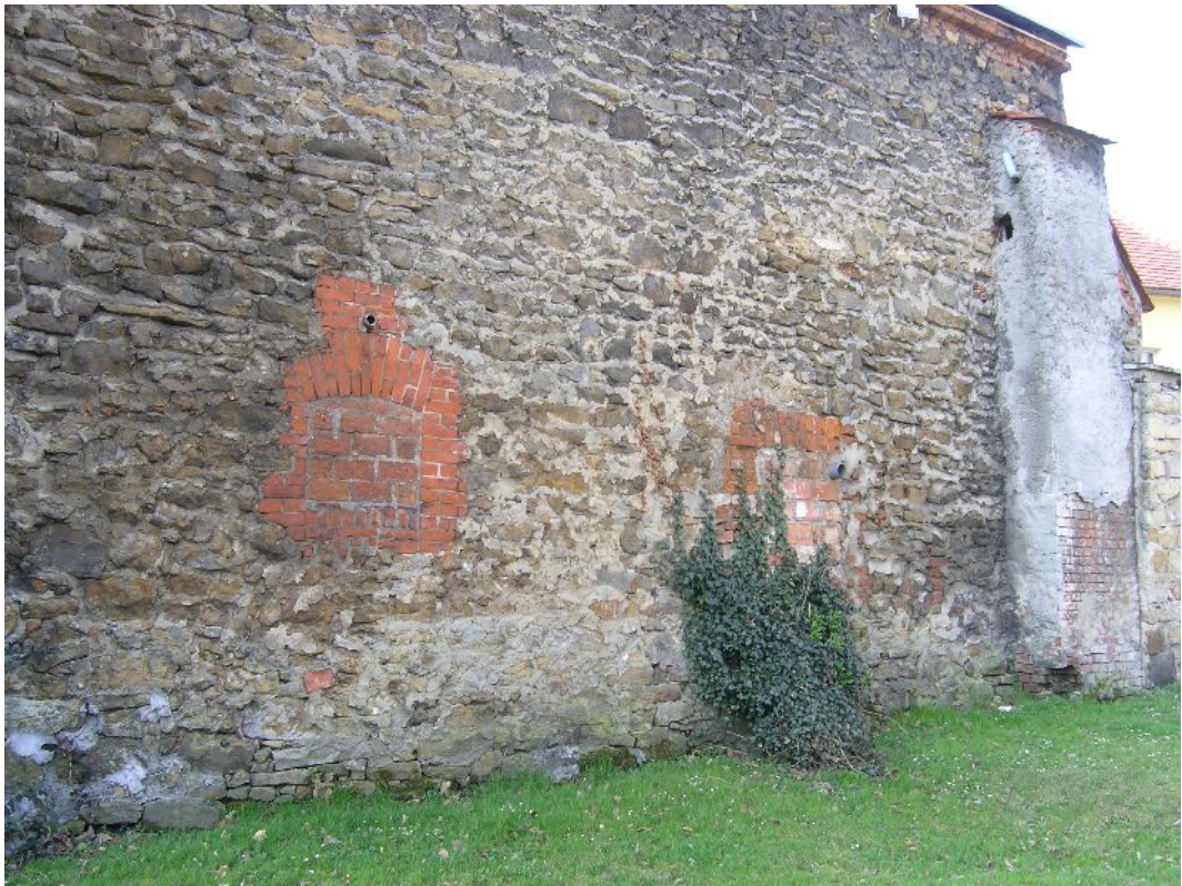
Fot. 23. /K-L/ Bardzo zniszczona ściana budynku – zwłaszcza cokół, przypora, przemurowania i uzupełnienia spoin
