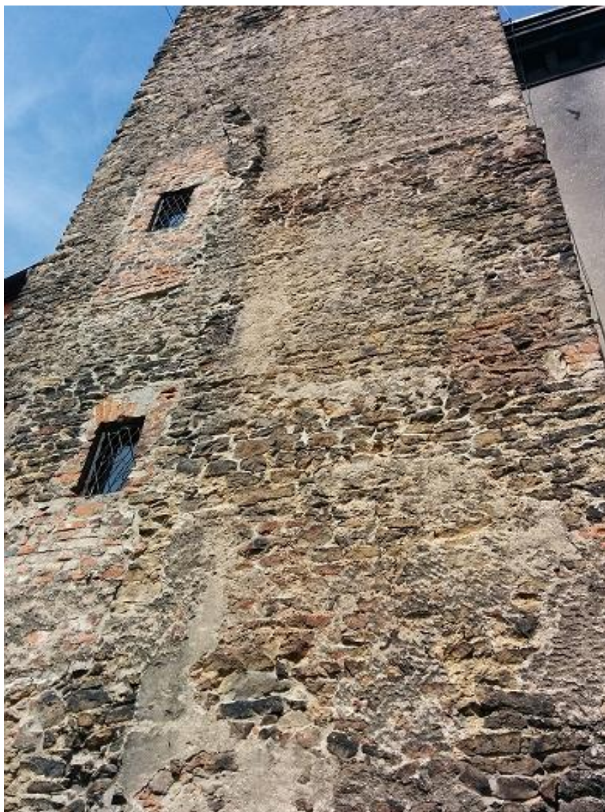
Fot. 4. Lico muru kamiennego – elewacja baszty. Widoczne relikty tynków i wtórne przemurowania cegłą
