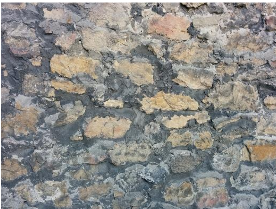
Fot. 39. Mur przy ul. Wojska Polskiego – wtórne, cementowe spoiny
