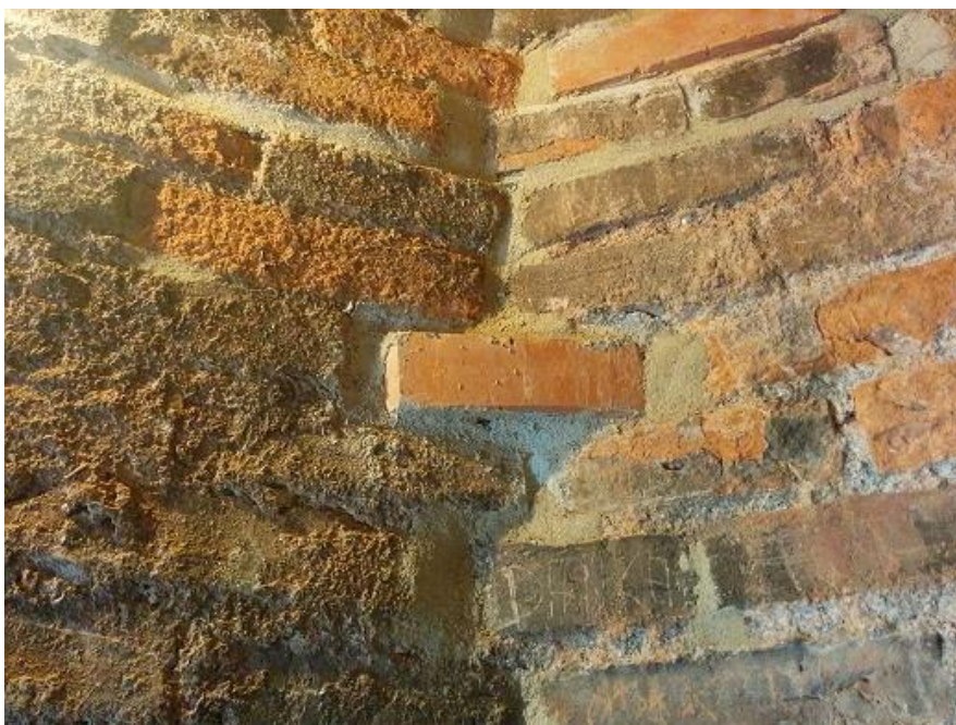
Fot. 13. Cementowe spoiny wewnątrz hełmu wieży oraz źle osadzona cegła – efekt niedawnego remontu
