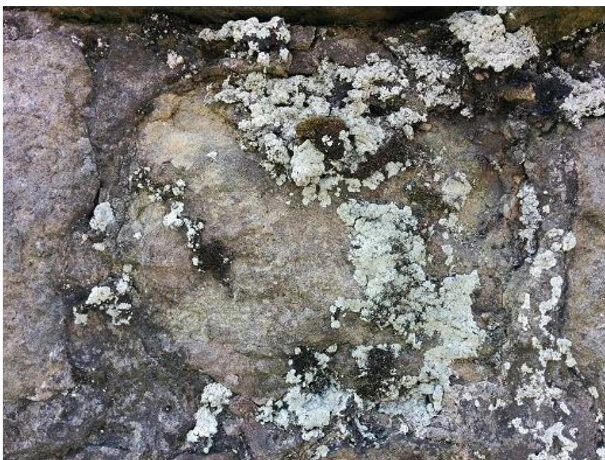
Fot. 58. Mur przy ul. Wojska Polskiego – porosty na powierzchni kamienia
