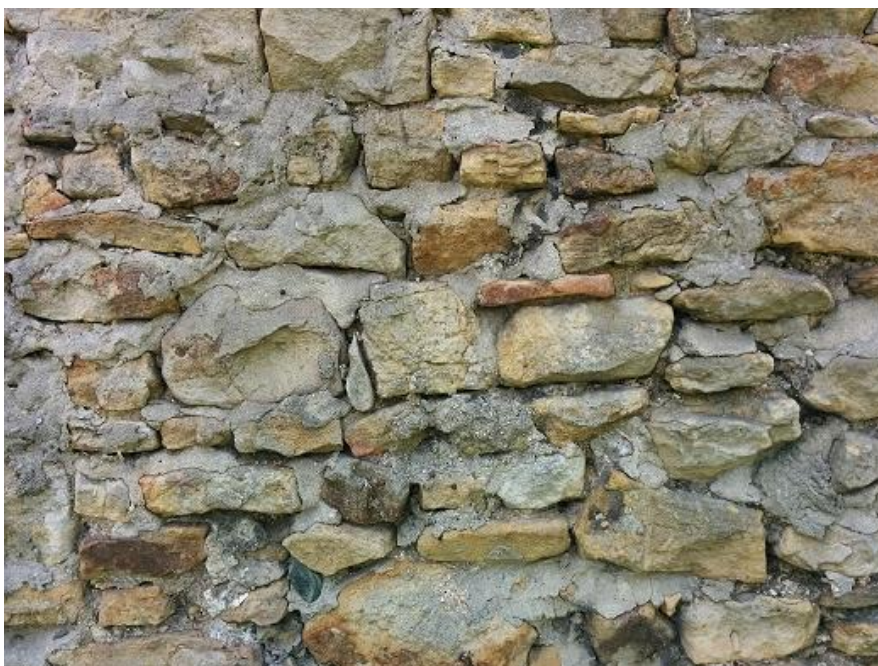
Fot. 37. Mur przy ul. Wojska Polskiego – ubytki spoin
