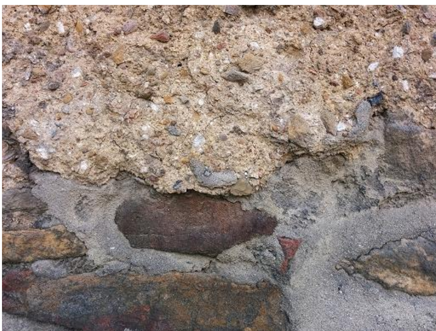
Fot. 44. Mur przy ul. Wojska Polskiego – wtórne, cementowe spoiny oraz relikty tynku wapiennego
