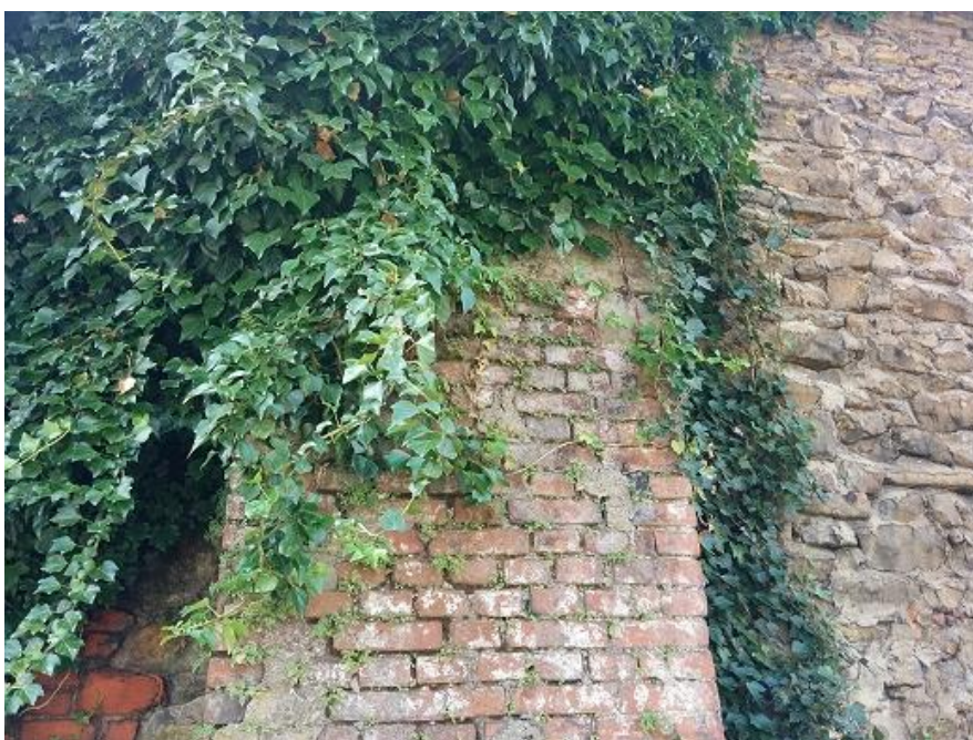
Fot. 56. Mur przy ul. Wojska Polskiego – wtórne naprawy cegłą oraz roślinność porastająca mur
