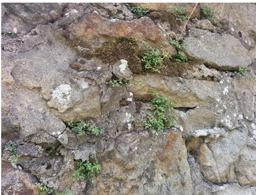
Fot. 60. Mur przy ul. Wojska Polskiego –roślinność porastająca mur
