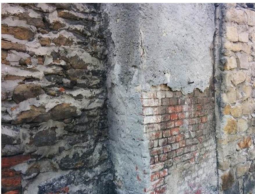
Fot. 46. Mur przy ul. Wojska Polskiego – wtórne przemurowanie cegłą oraz odspojony tynk cementowy na wążku ceglany
