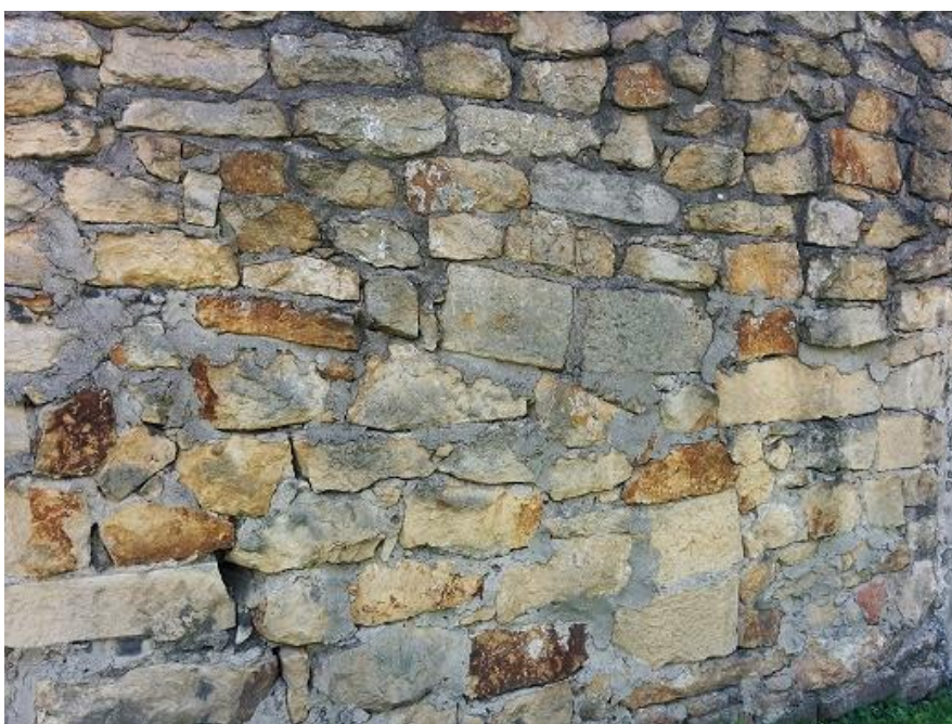
Fot. 38. Mur przy ul. Wojska Polskiego – wtórne, cementowe spoiny
