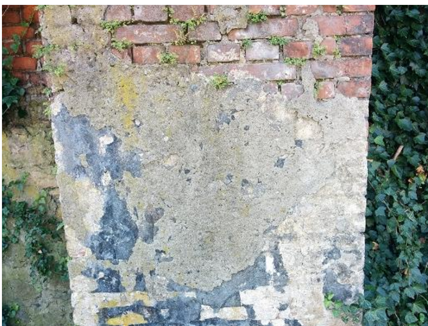
Fot. 54. Mur przy ul. Wojska Polskiego – wtórne przemurowanie cegłą oraz odspojony tynk cementowy na wążku ceglanym
