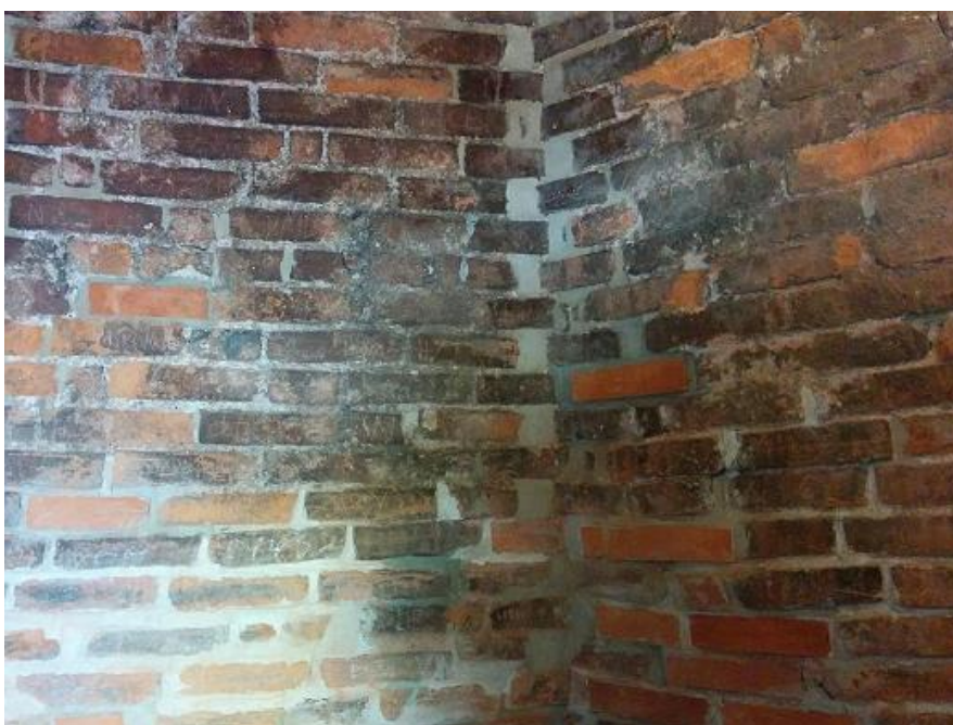
Fot. 12. Cementowe spoiny wewnątrz hełmu wieży
