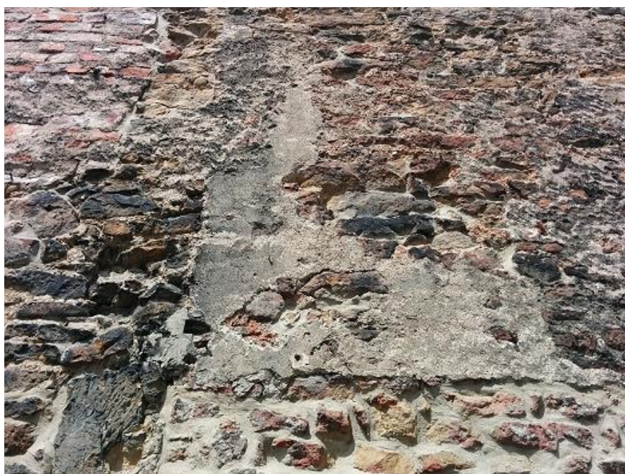
Fot. 6. Fragmenty tynku wapiennego na elewacji wieży
