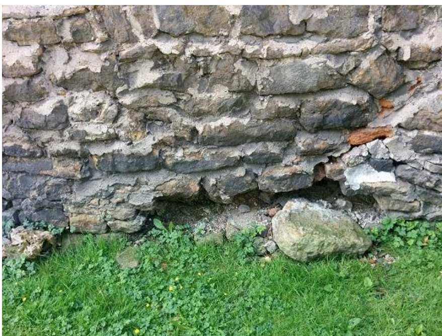
Fot. 50. Mur przy ul. Wojska Polskiego – ubytek kamieni w licu muru
