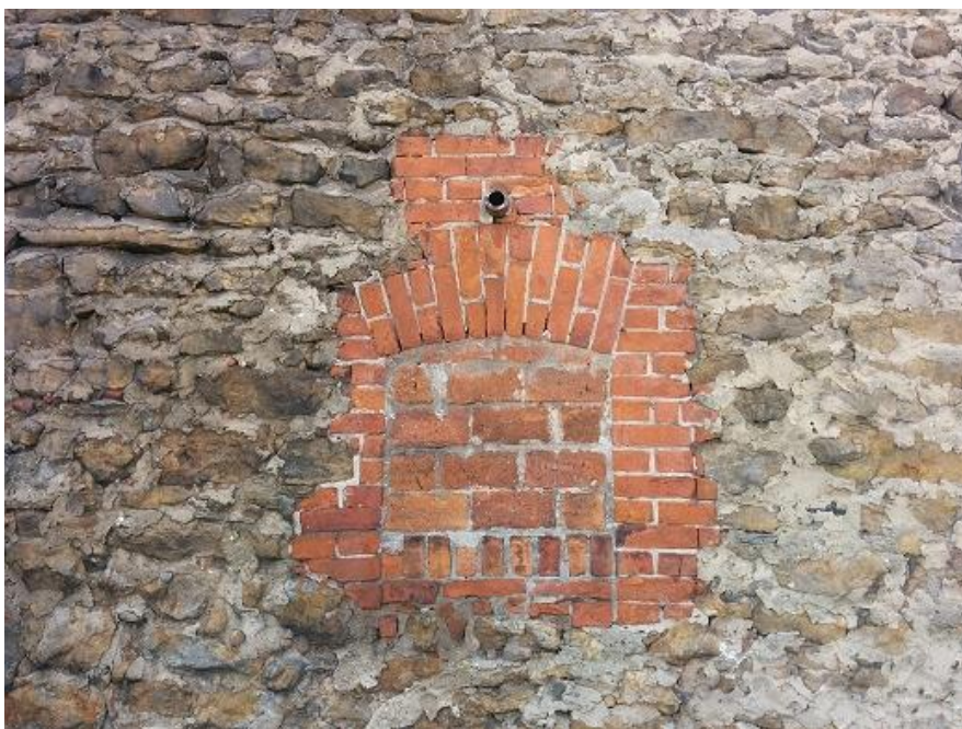
Fot. 55. Mur przy ul. Wojska Polskiego – wtórne naprawy cegłą
