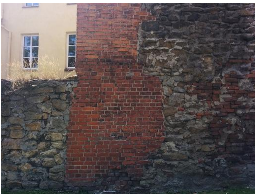
Fot. 52. Mur przy ul. Wojska Polskiego – wtórne naprawy cegłą
