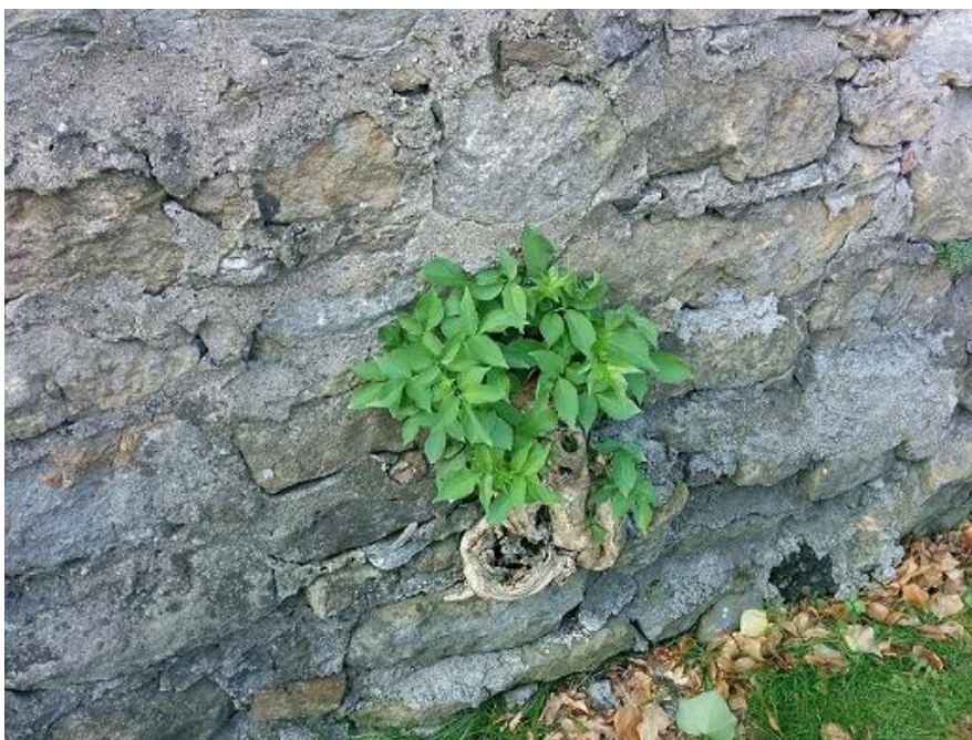
Fot. 59. Mur przy ul. Wojska Polskiego –roślinność porastająca mur
