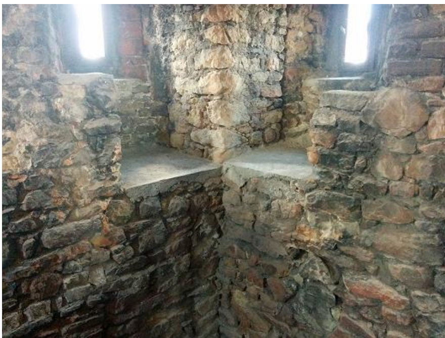
Fot. 17. Cementowe spływy w miejscu pierwotnego zwieńczenia baszty
