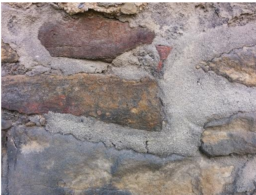
Fot. 43. Mur przy ul. Wojska Polskiego – wtórne, cementowe spoiny
