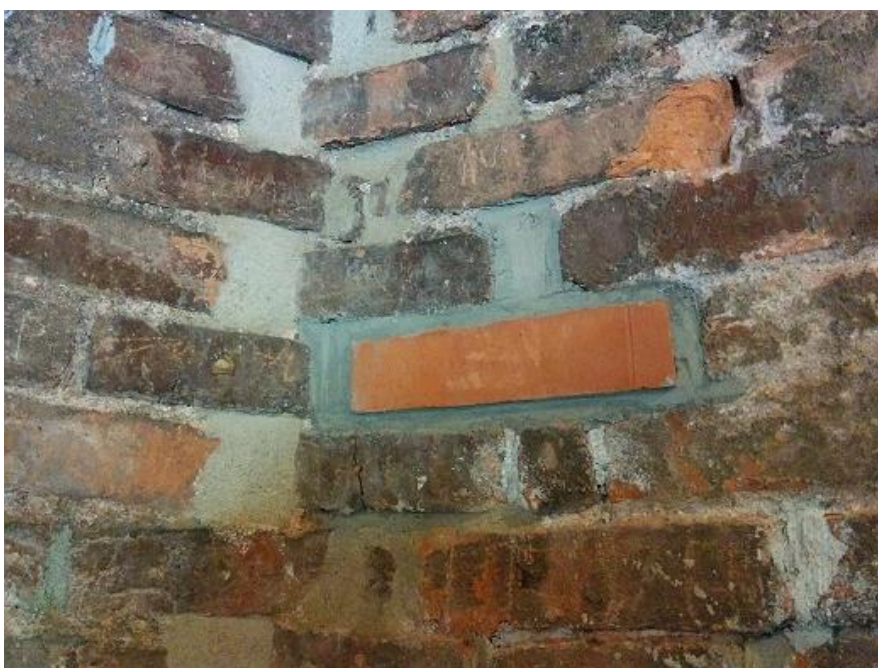
Fot. 14. Cementowe spoiny wewnątrz hełmu wieży oraz źle dobrana cegła wstawiona w miejsce zniszczonej
