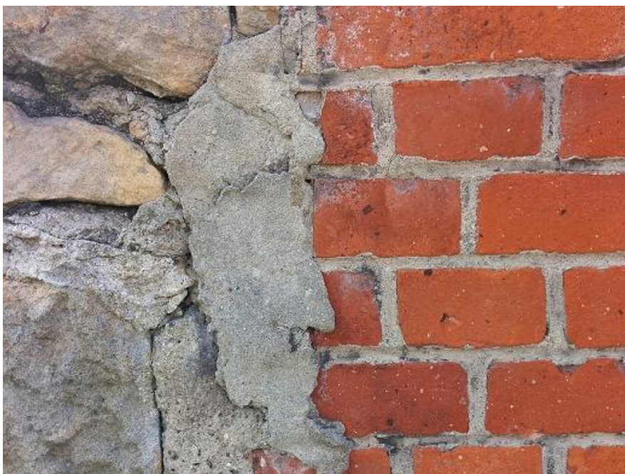
Fot. 53. Mur przy ul. Wojska Polskiego – wtórne naprawy cegłą
