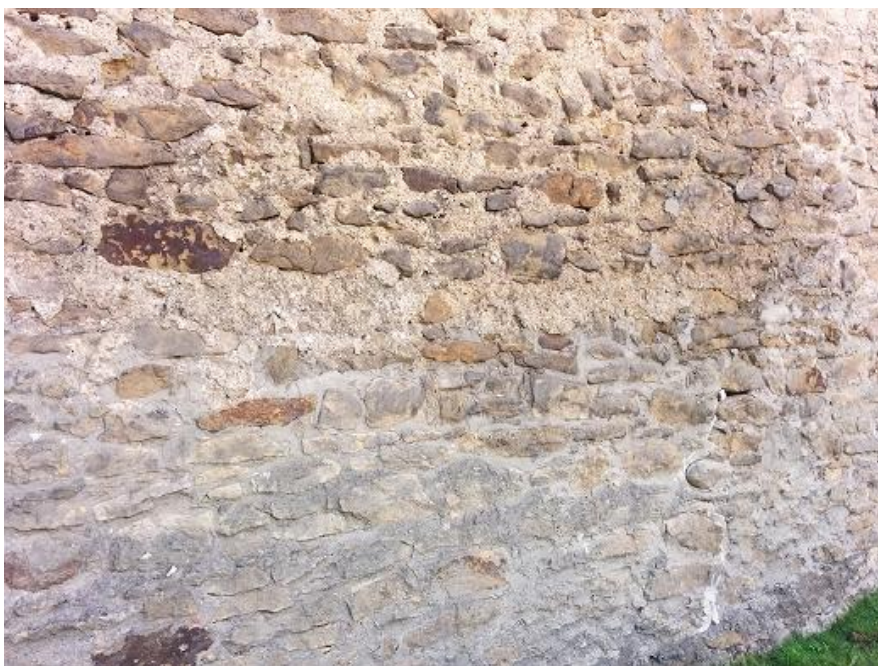
Fot. 41. Mur przy ul. Wojska Polskiego – wtórne, cementowe spoiny oraz resztki wapiennych tynków
