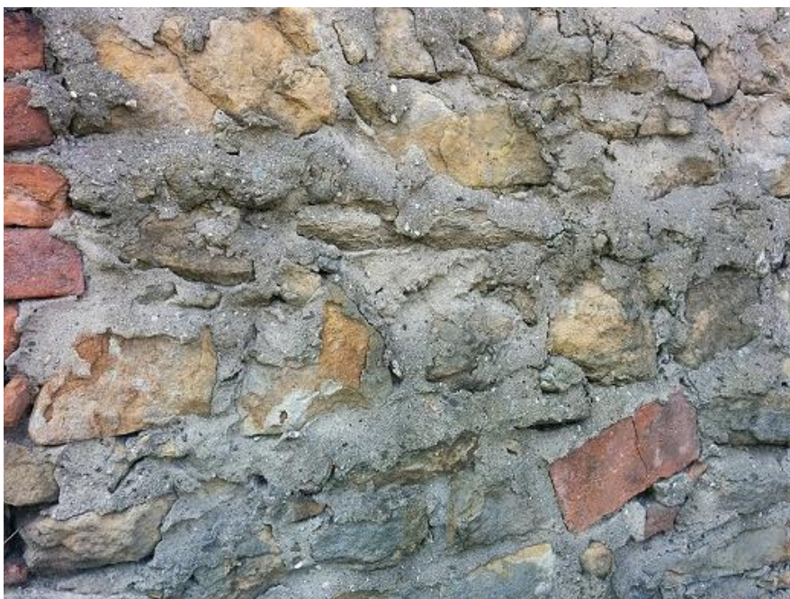
Fot. 47. Mur przy ul. Wojska Polskiego – wtórne, cementowe spoiny
