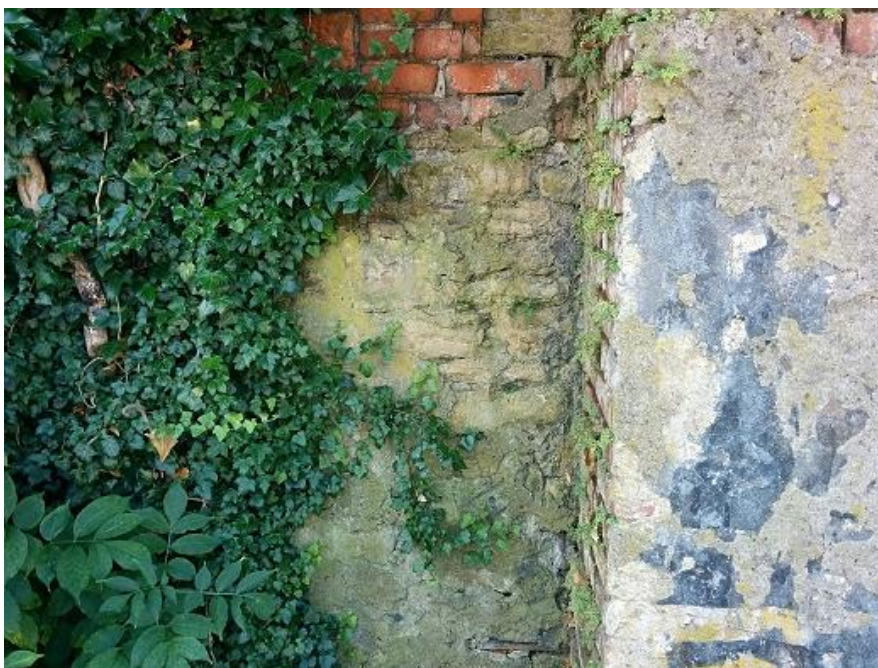
Fot. 57. Mur przy ul. Wojska Polskiego – wtórne naprawy cegłą oraz roślinność porastająca mur
