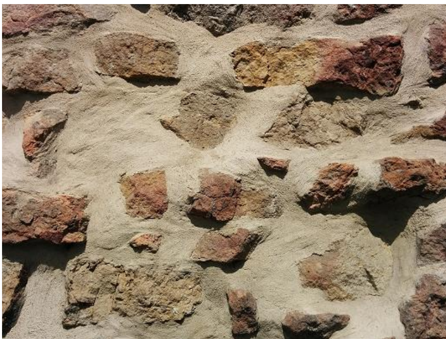
Fot. 7. Fragment ze spoiną założoną podczas ostatniego remontu elewacji
