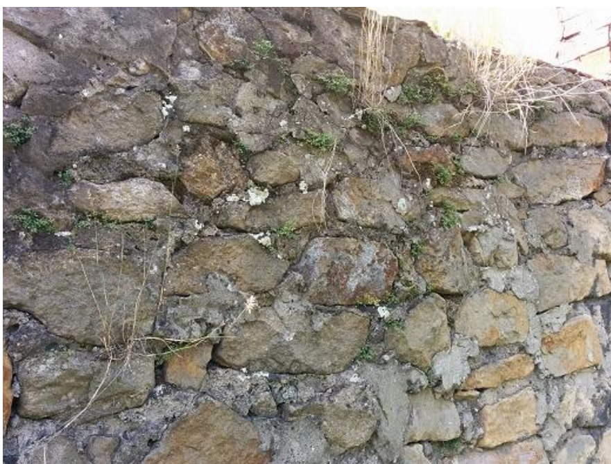
Fot. 40. Mur przy ul. Wojska Polskiego – wtórne, cementowe spoiny
