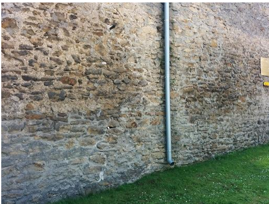
Fot. 45. Mur przy ul. Wojska Polskiego – zawilgocony fragment
