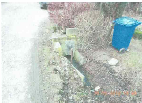
Ścianka czołowa przepusty do wymiany
