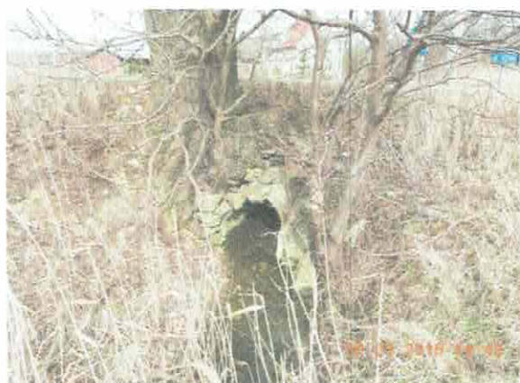
Drzewo do wycięcia. Ścianka czołowa przepustu do remontu
