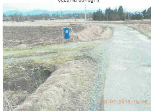
Zjazd indywidualny. Brak ścianek czołowych przepustu
