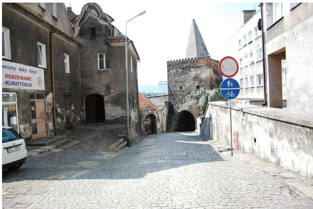
Fotografia 4. Ubytki w elewacjach zabytkowych budynków
